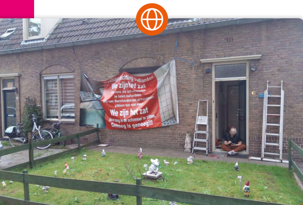
Figuur 9: Vocht- en schimmelproblemen in woningen van woningcorporatie Stadlander, Bron: ZuidWest
